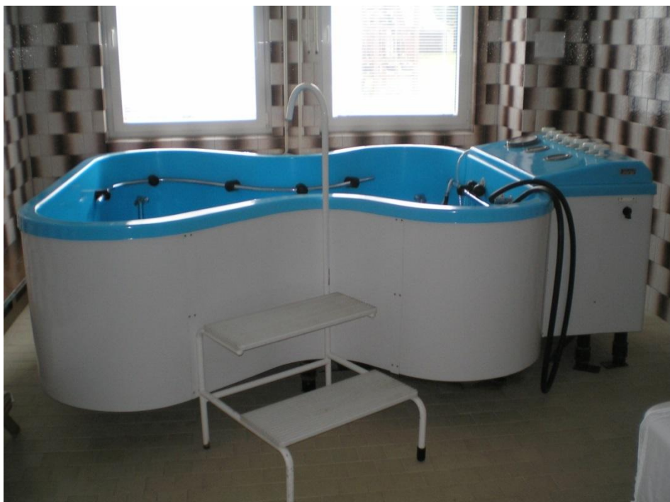
Zdravotno-rehabilitačná časť - Hubardov kúpeľ
